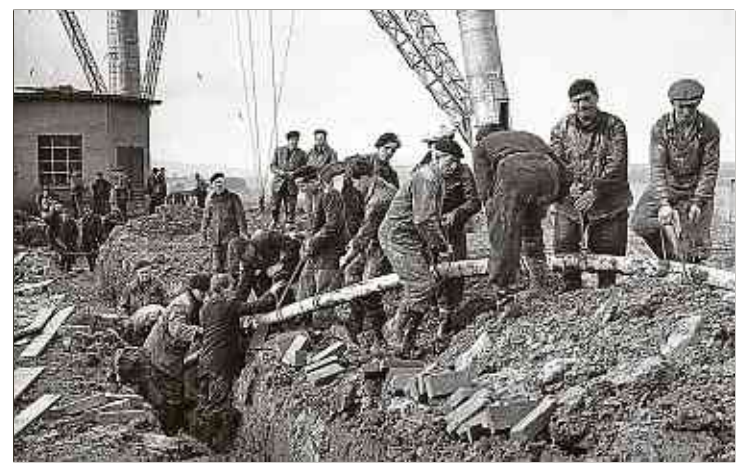
Modernisierung: 1954 ließ RTL in Junglinster zwei 250 Meter hohe Masten errichten. (FOTO: POL ASCHMAN / PHOTOTHÈQUE DE LA VILLE DE LUXEMBOURG)
